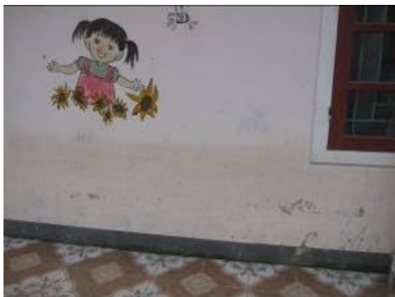
Hình 5. Vết lũ tháng 10/2013 tại trường Mầm non thôn Tân Dừa – Hýõng Trạch
