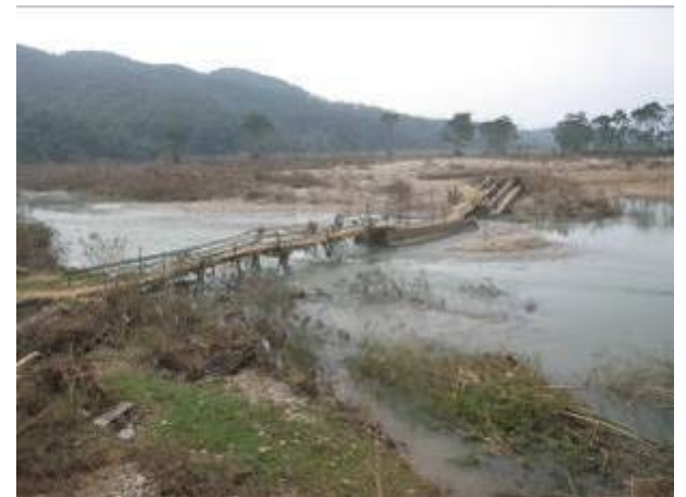
Hình 24. Cầu tạm Đá Đón – Sơn Kim 2 được nhân dân và chính quyền xây dựng ở thôn Làng Chè
