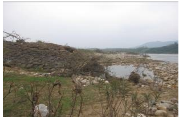
Hình 18. Kè đá bị nước lũ phá hủy gần như hoàn toàn tại xã Sơn Kim 2 – Hương Sơn
