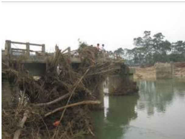
Hình 23 Cầu Đá Đón – Sơn Kim 2 bị nước lũ phá hủy hoàn toàn
