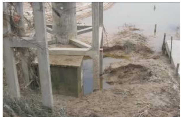
Hình 30. Hệ thống đo mực nước tự động tại trạm Sơn Diệm đã bị hỏng
