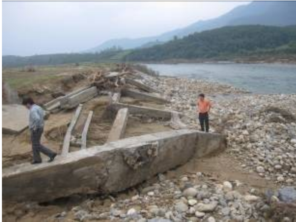
Hình 19. Hệ thống công trình bảo vệ bờ bị phá hủy do lũ tại xã Sơn Kim 2 – Hương Sơn
