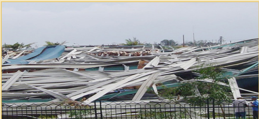
Xưởng lắp ráp xe máy Deahan vị sụp đổ hoàn toàn sau bão Xangsane 2006
